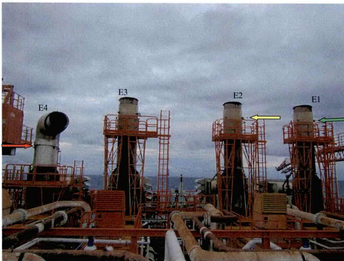
Foto 1: Punti di emissione attivi E1, E3 ed E4, con l'indicazione, mediante freccia colorata, delle flange di prelievo.
