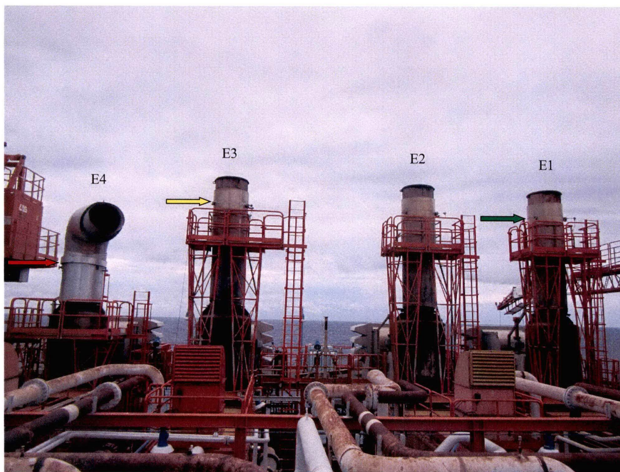
Foto 1: Punti di emissione attivi E1, E3 ed E4, con l'indicazione, mediante freccia colorata, delle flange di prelievo.
