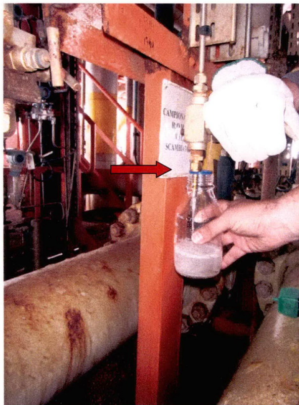
Foto 2 - Campionamento allo scarico delle acque di raffreddamento "SF1"
