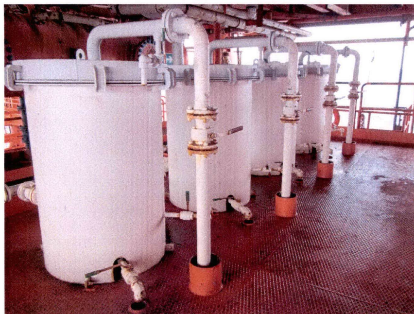
Foto 5 - Impianto di trattamento con filtri a carbone attivo
