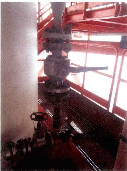
Foto 2 – Impianto a monte filtri.
