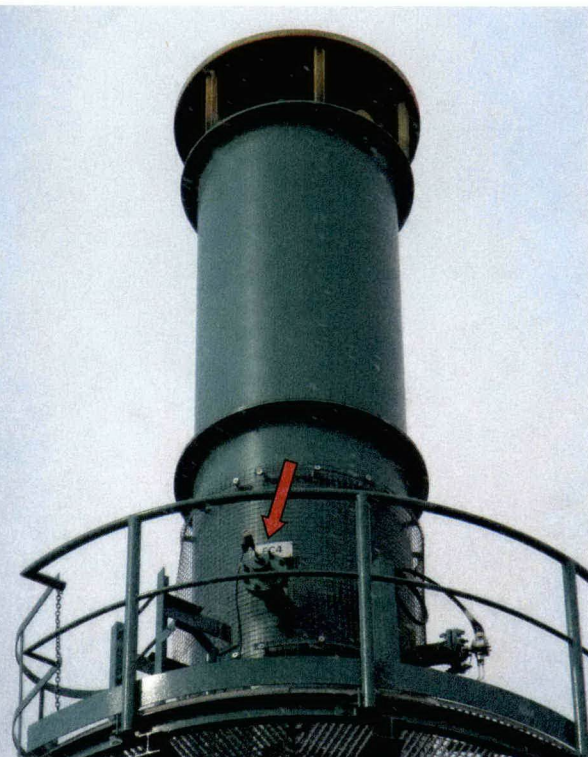
Foto 5: Punto di prelievo dei fumi (freccia rossa)
