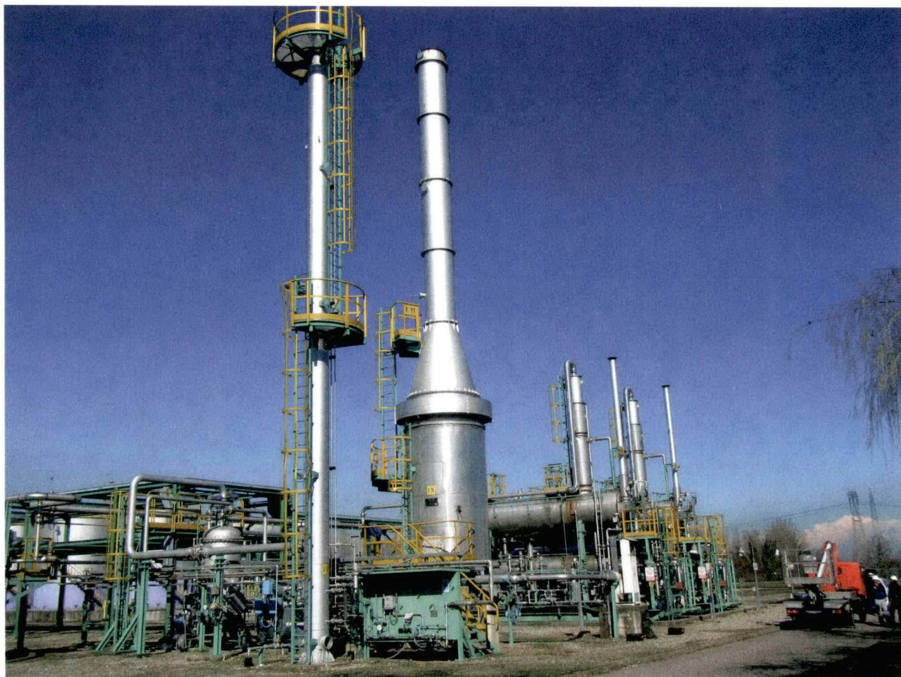
Centrale “Settala stoccaggio” – Termodistruttore e rigeneratori TEG
