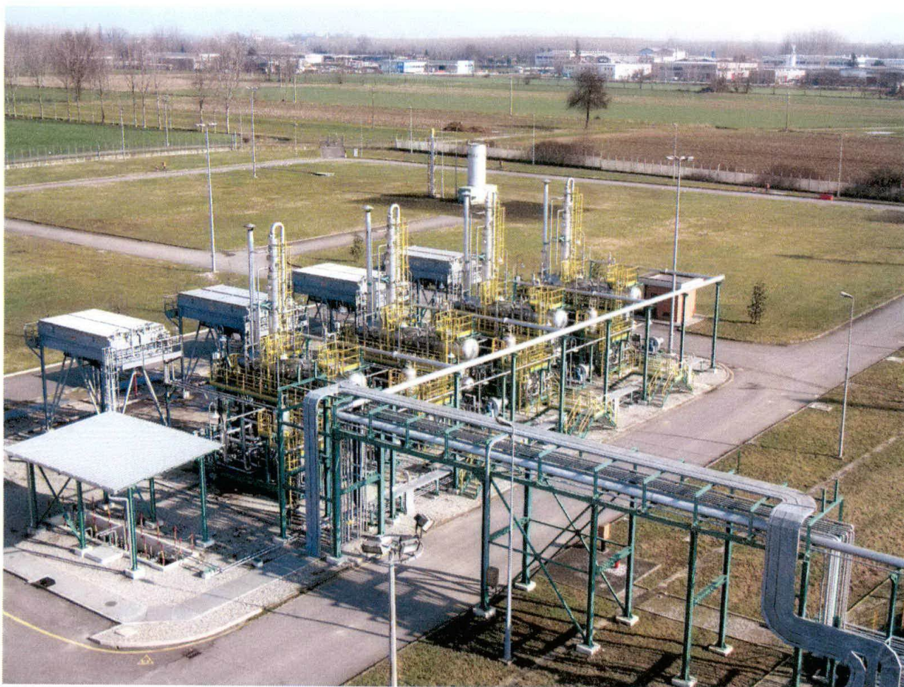
Centrale “Sergnano stoccaggio” – Rigeneratori glicol trietilenico
