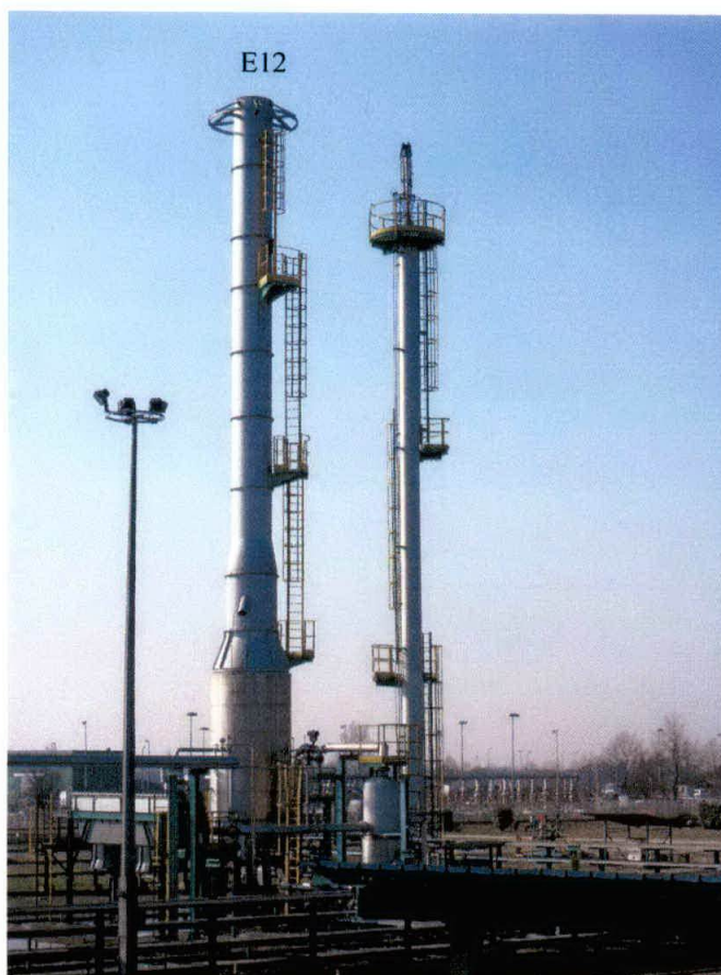
Fig. 4: Punto di emissione E12 termodistruttore
