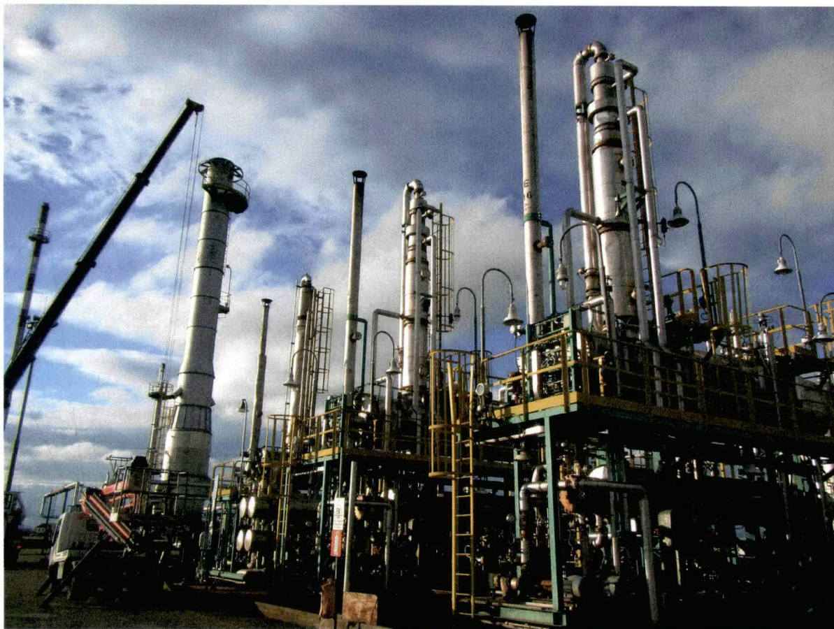
Centrale “Sabbioncello stoccaggio” – rigeneratori glicol e termodistruttore
