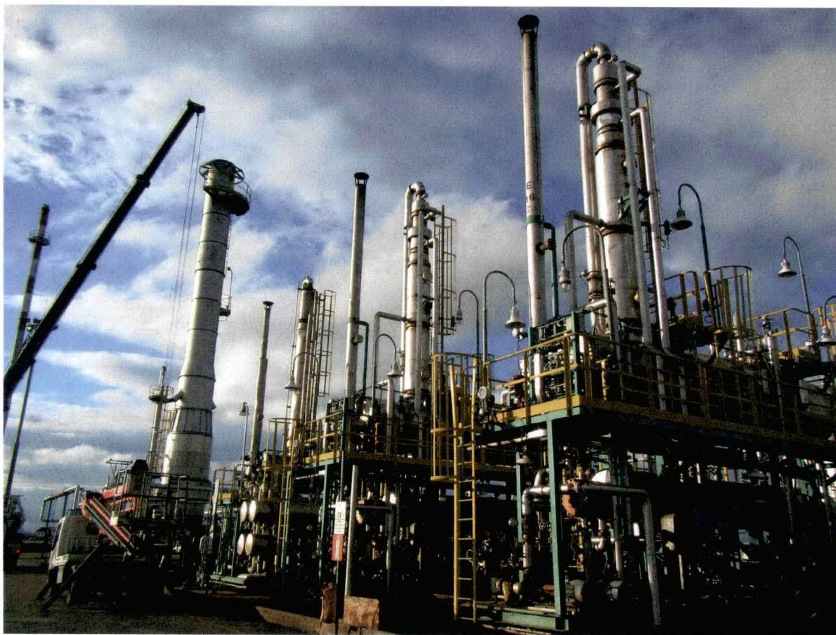
Centrale “Sabbioncello stoccaggio” – rigeneratori glicol e termodistruttore
