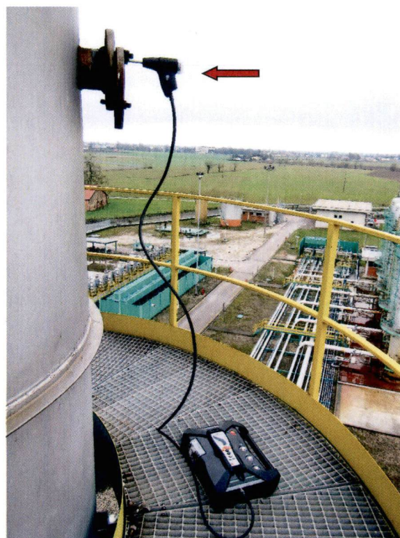
Fig. 3: Punto di prelievo dei fumi (freccia rossa)
