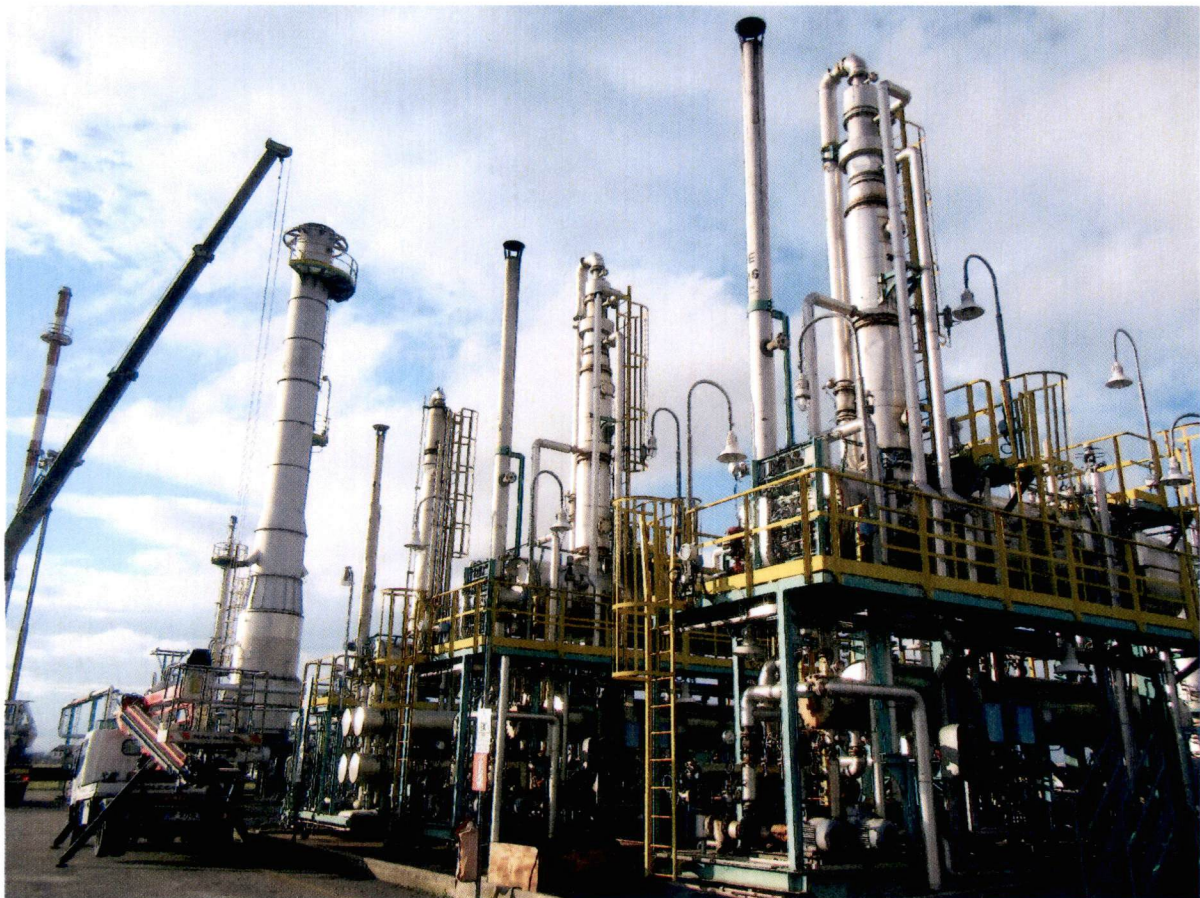
Centrale “Sabbioncello stoccaggio” – rigeneratori glicol e termodistruttore
