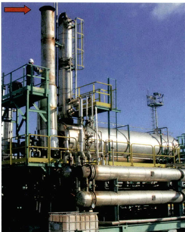
Foto 4: Punto di emissione E13
