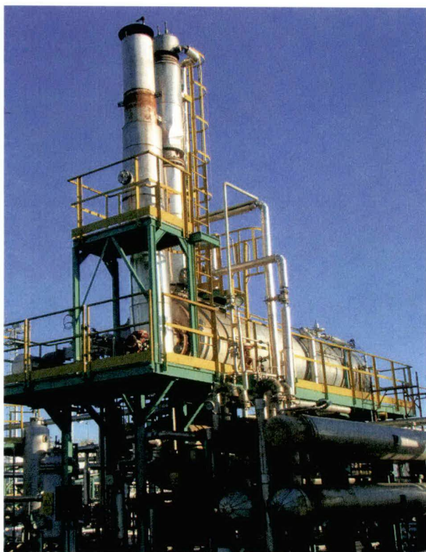
Foto 6: Punto di emissione E12
