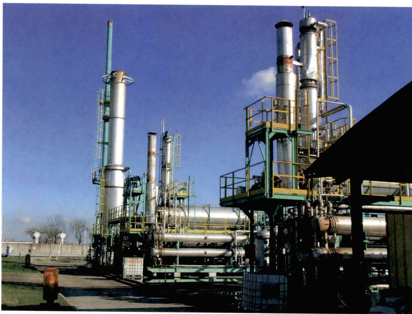
Centrale “Ripalta stoccaggio”: rigeneratori TEG e termodistruttore
