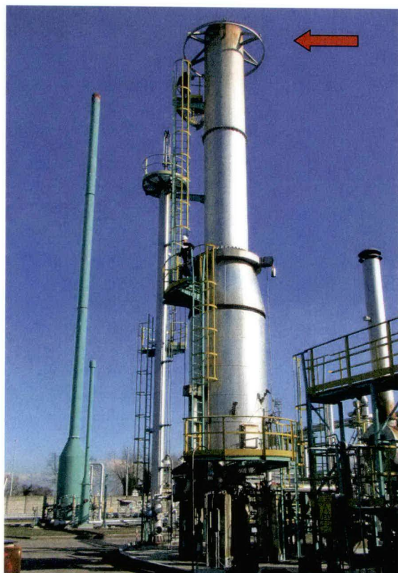
Foto 2: Punto di emissione E11
