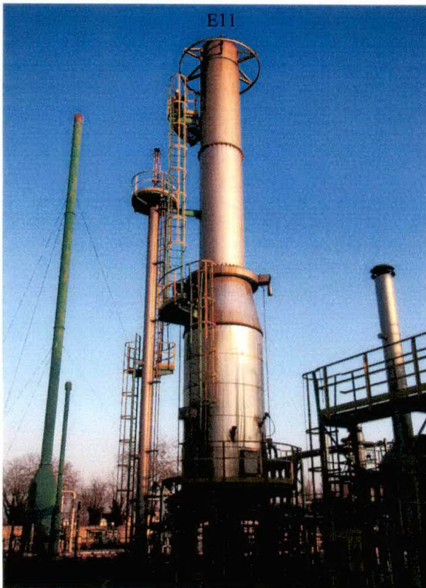
Fig. 4: Punto di emissione E11 termodistruttore
