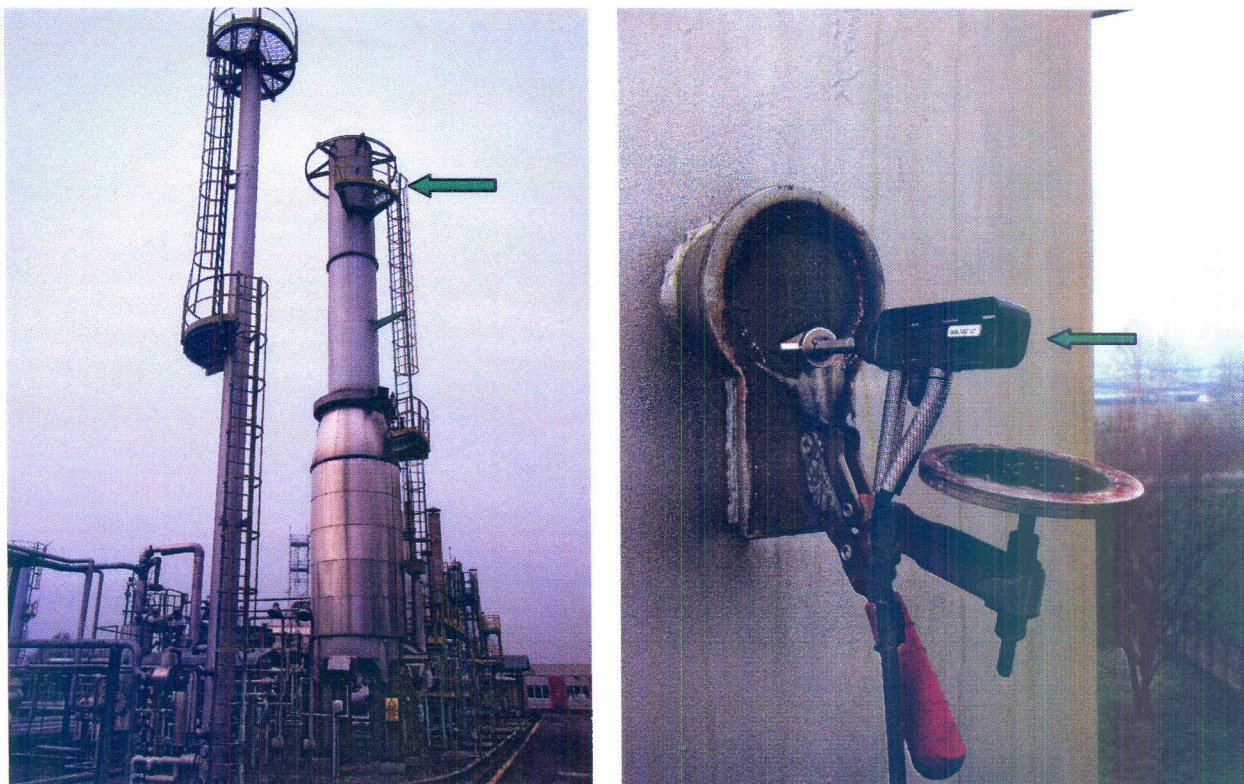
Foto 3: Termodistruttore e punto di prelievo nel camino E11 (freccia verde)
