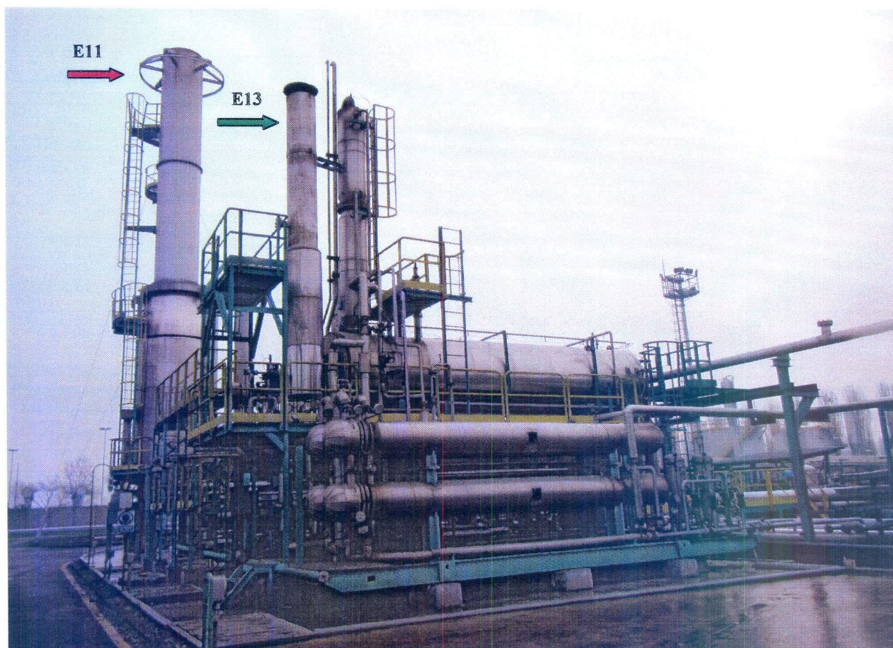
Termodistruttore (freccia rossa) e Rigeneratore glicol trietilenico “RG3” (freccia verde)
