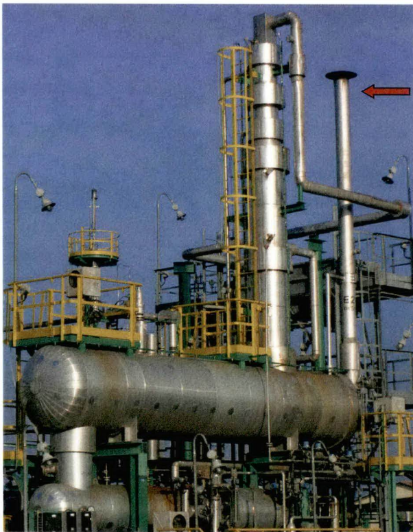
Foto 4 - punto di emissione E26
