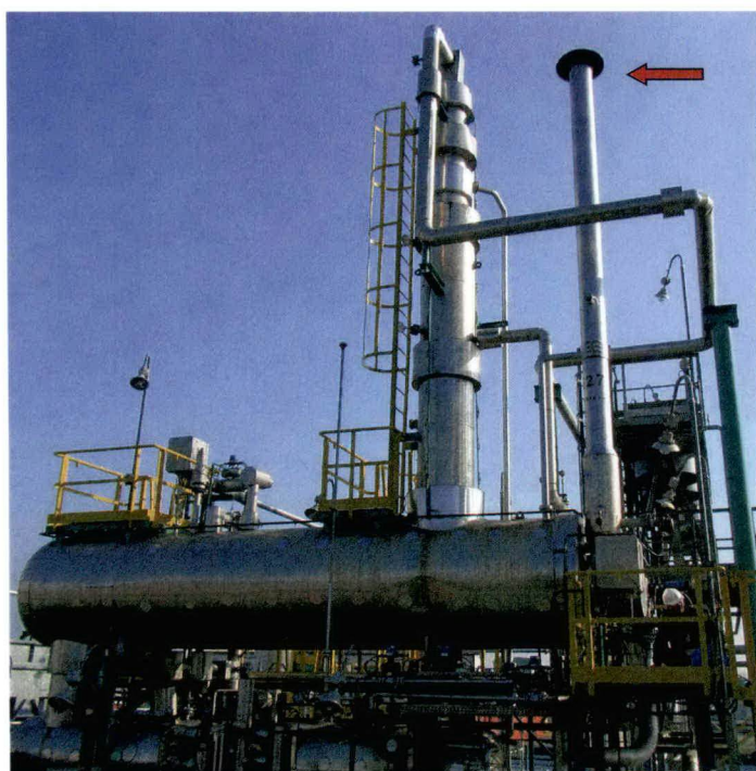
Foto 5 - Punto di emissione E27
