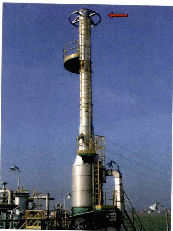
Foto 2 - punto di emissione E25
