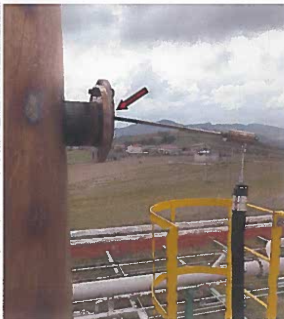
Fig. 3: Punto di prelievo dei fumi (freccia rossa)
