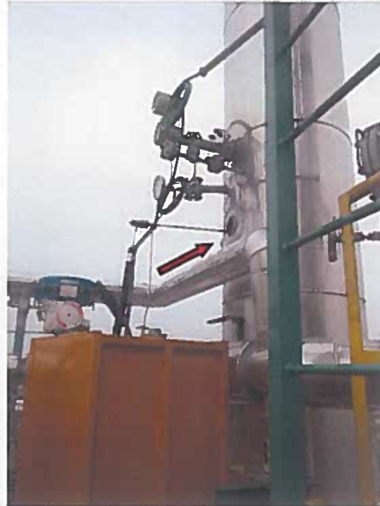
Fig. 6: Punto di prelievo dei fumi (freccia rossa)
