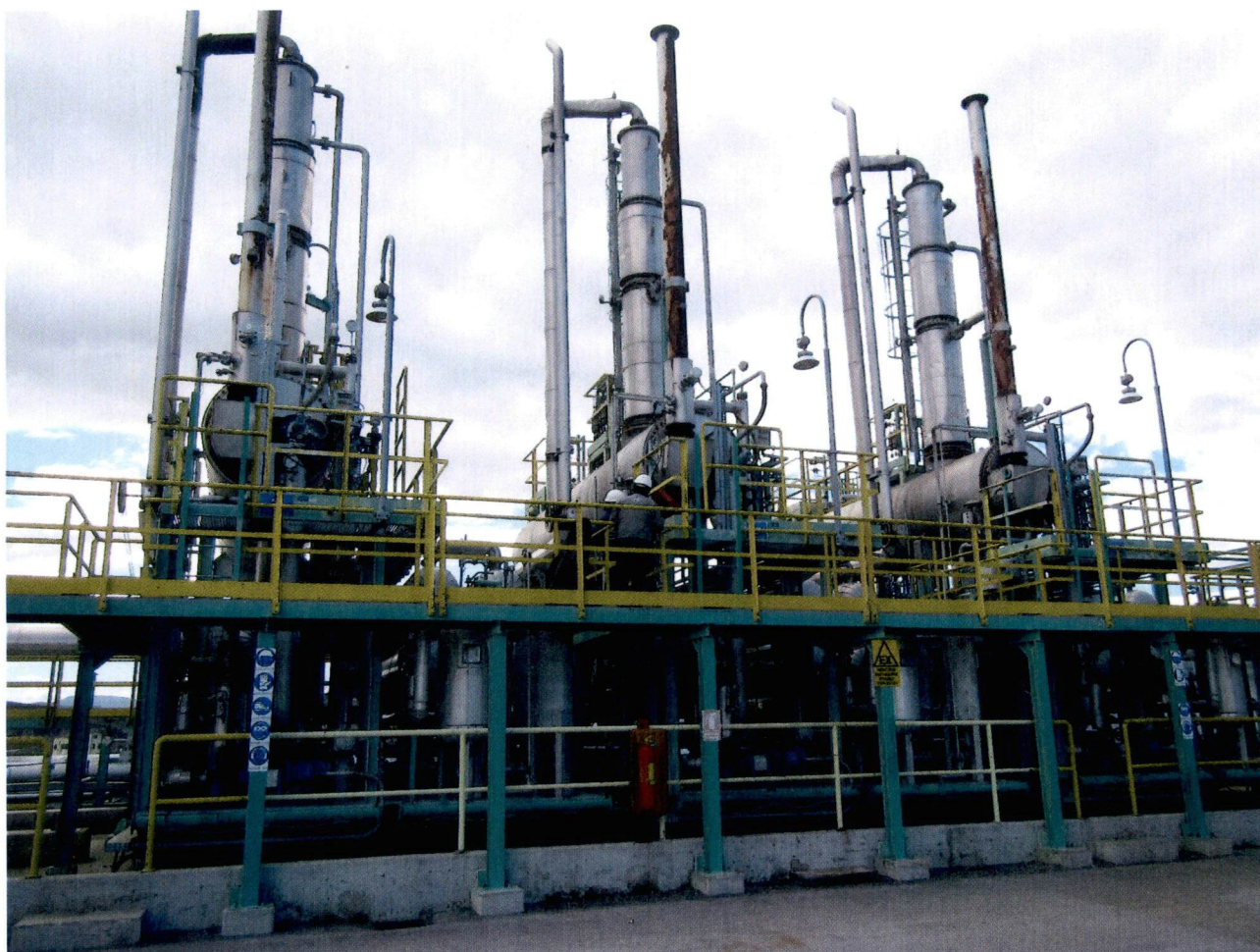
Centrale “Fiume Treste stoccaggio” – Rigeneratori glicol trietilenico (TEG)
