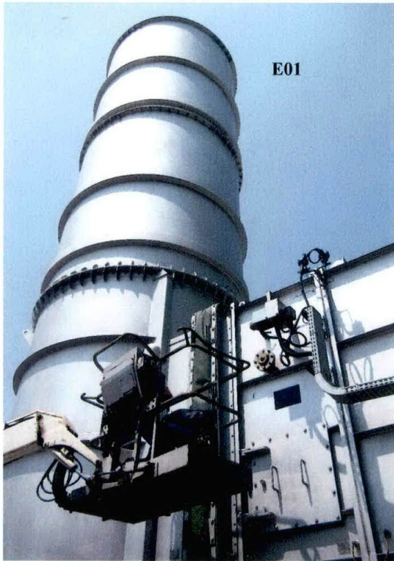
Fig. 2: Punto di emissione E01 Turbina a gas Heavy Duty
