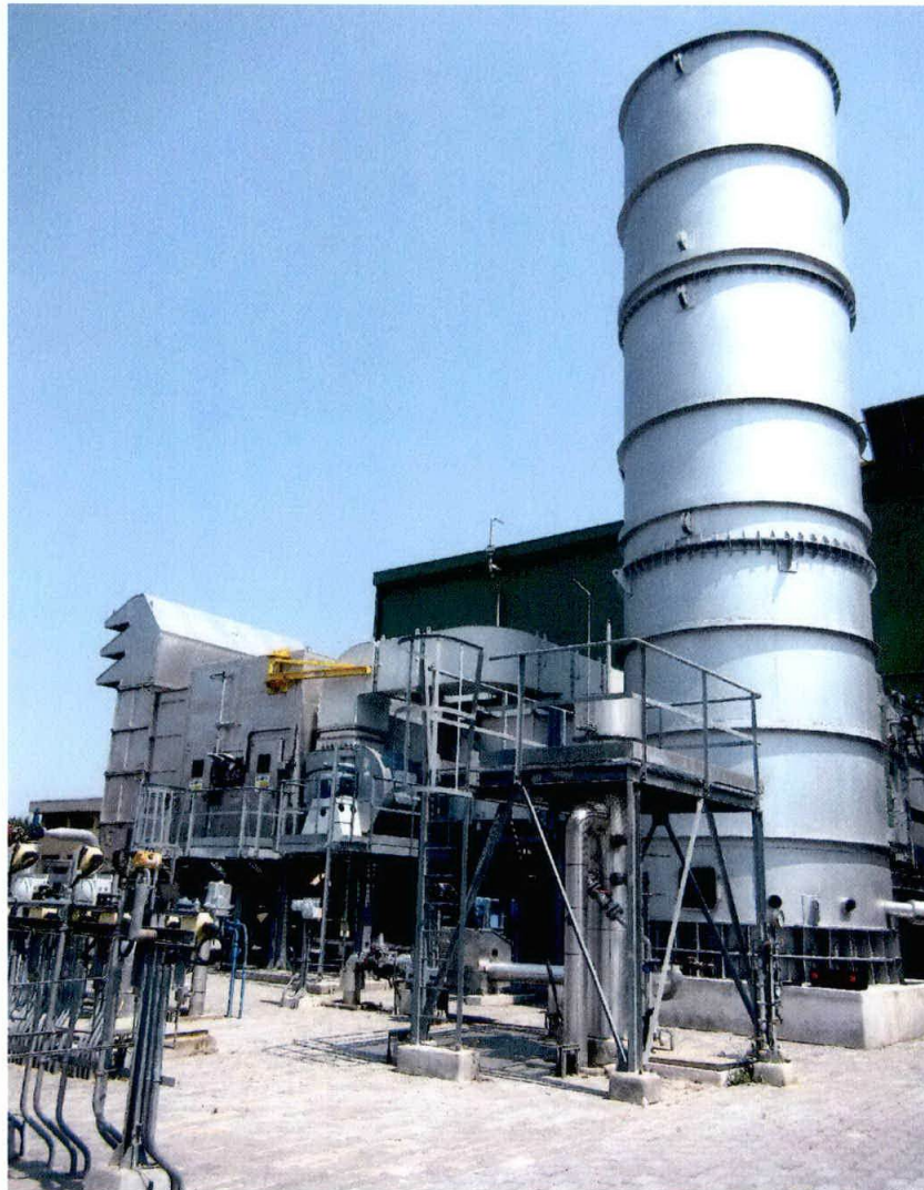
Centrale “Fiume Treste stoccaggio” – Turbina a gas tipo Heavy Duty “TC1”
