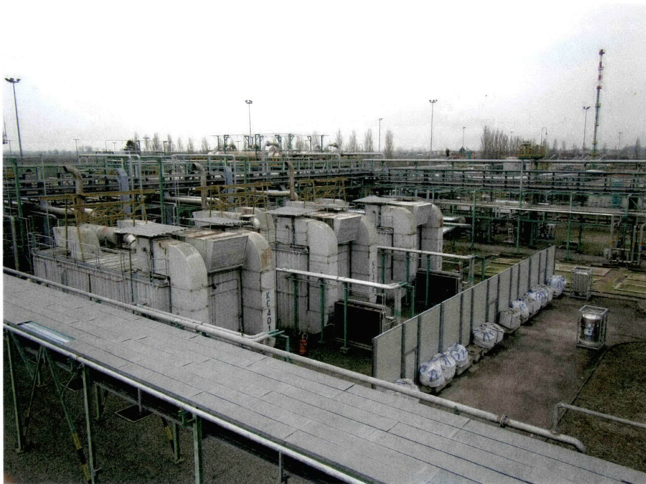
Centrale “Cortemaggiore stoccaggio” – motocompressori ciclo frigo
