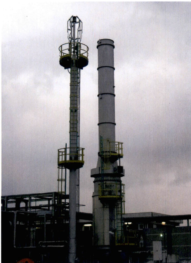
Centrale “Cortemaggiore stoccaggio” – Termodistruttore
