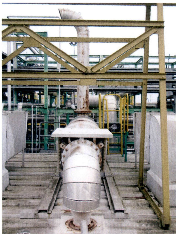
Fig. 2: Punto di emissione E002 motocompressore MG402
