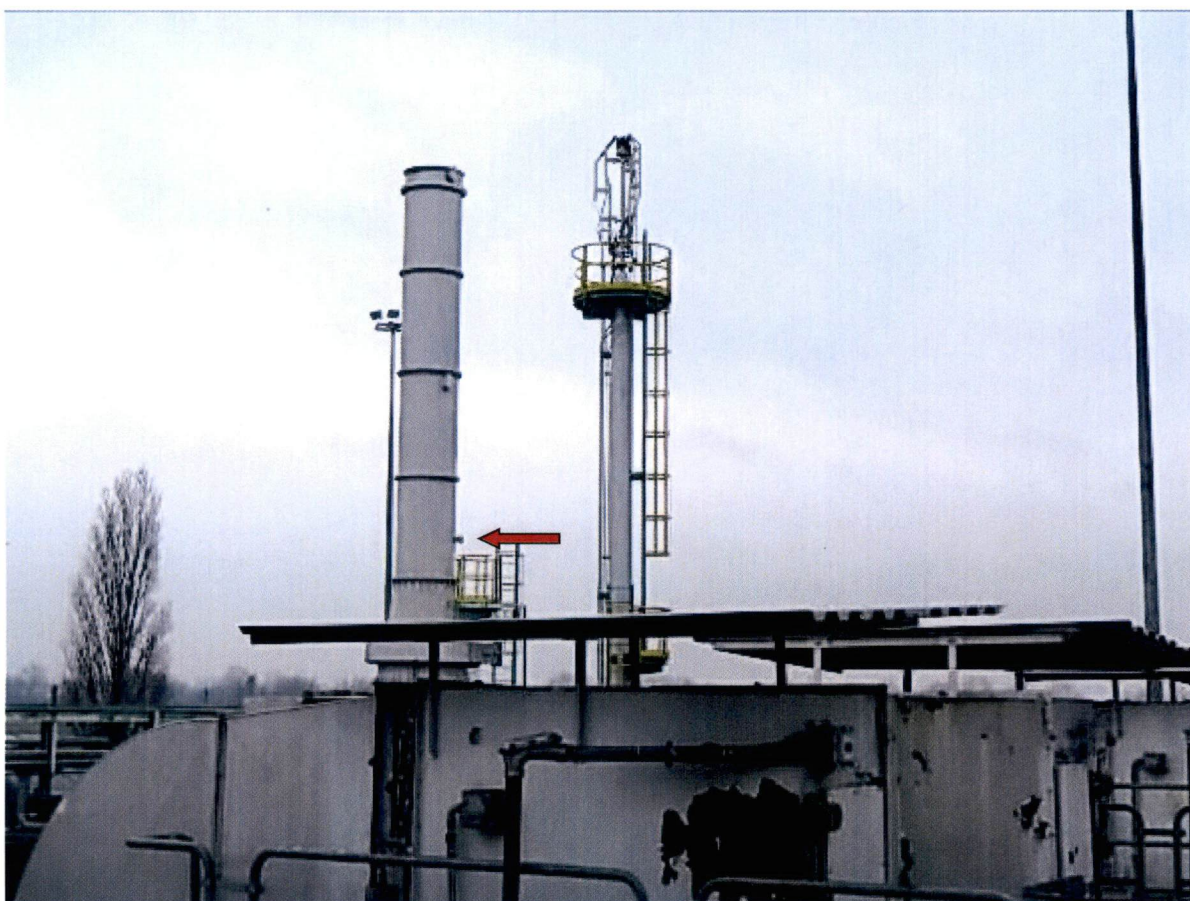
Fig. 5 Punto di emissione E11 - termodistruttore
