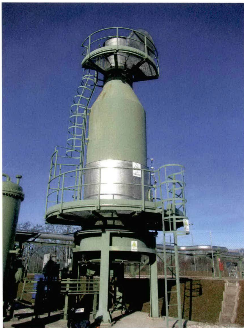
Centrale “Collalto” - Termodistruttore
