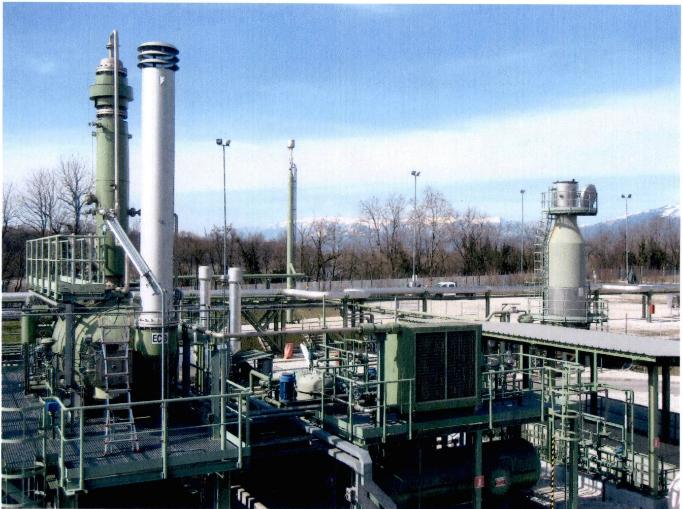
Centrale “Collalto” – Rigeneratore TEG e termodistruttore
