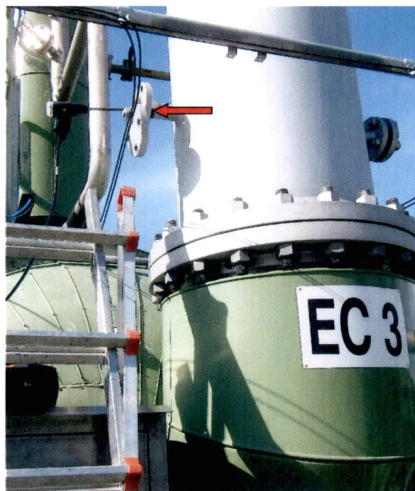
Fig. 3: Punto di prelievo dei fumi (freccia rossa)
