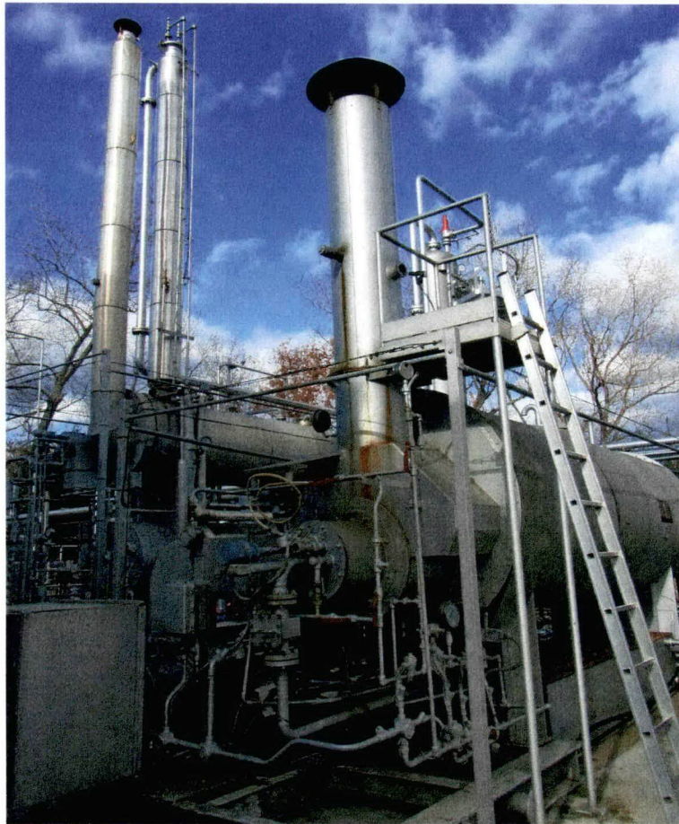
Centrale “Cellino Stoccaggio” – Termodistruttore
