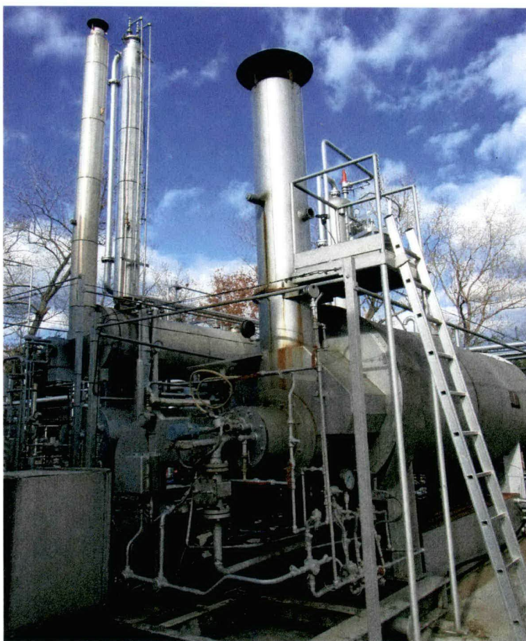
Centrale “Cellino Stoccaggio” – Termodistruttore
