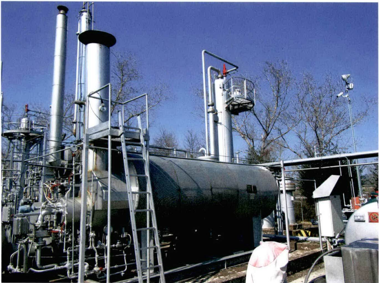
Centrale “Cellino Stoccaggio” – Termodistruttore
