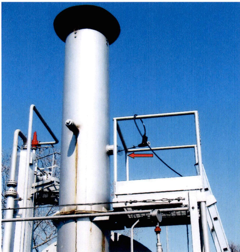
Fig. 2: Punto di prelievo dei fumi (freccia rossa)
