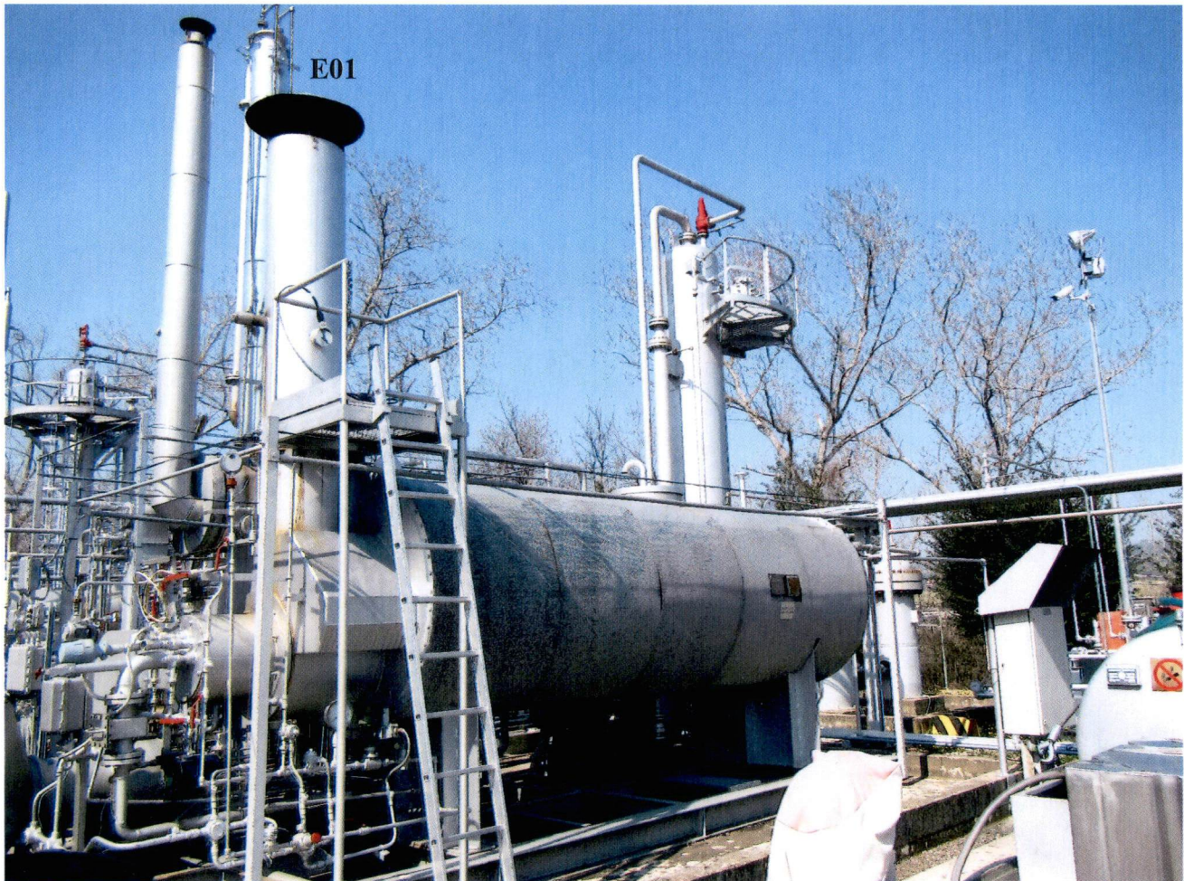
Centrale “Cellino Stoccaggio” – Termodistruttore
