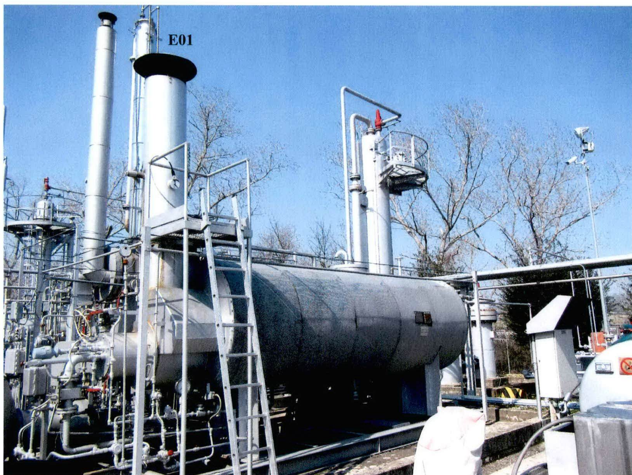
Centrale “Cellino” – Termodistruttore
