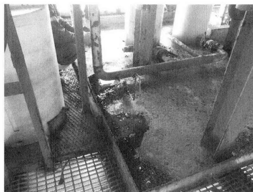
Foto 3 -Impianto di filtrazione (presa a valle)
